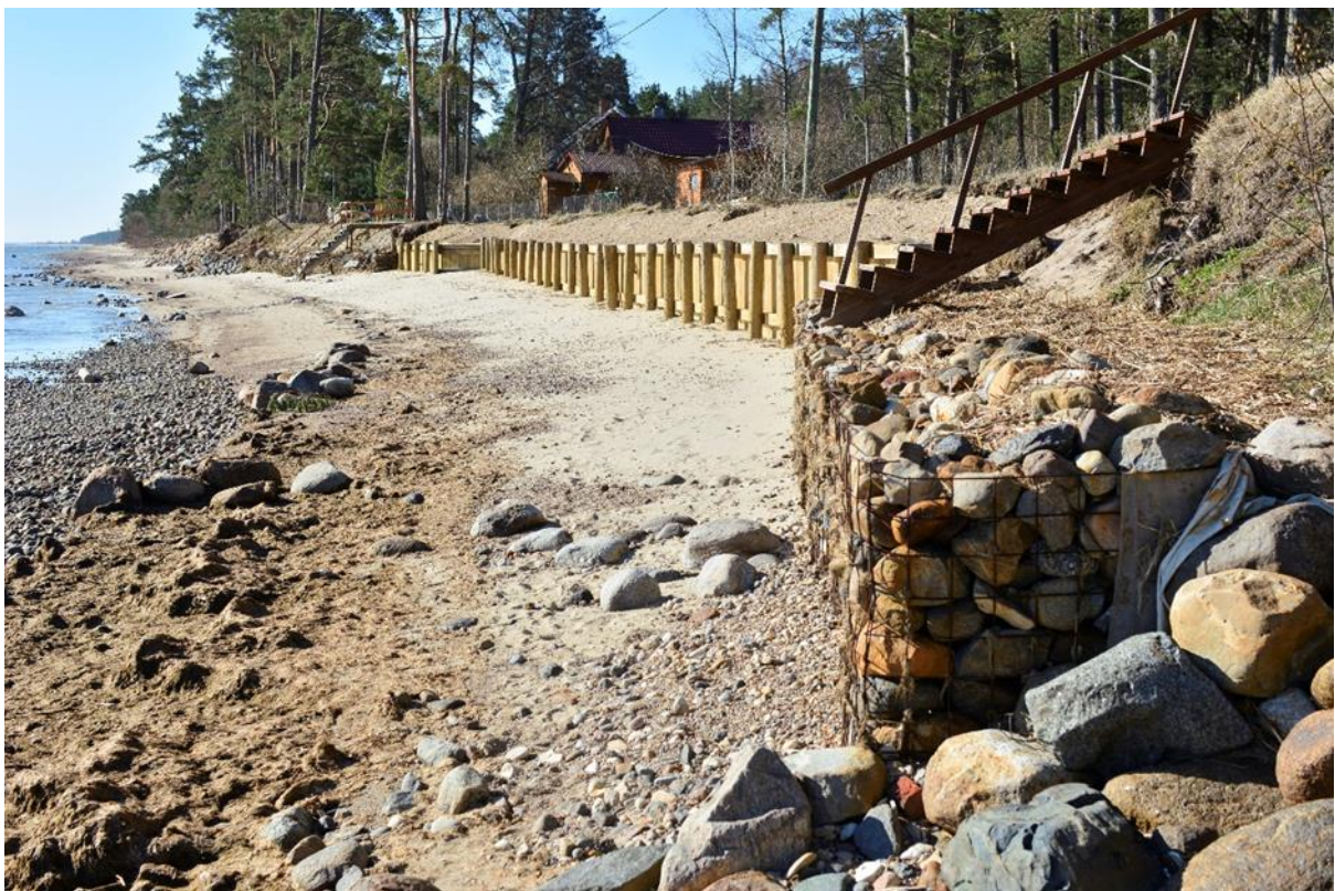
4.6. attēls: Pasīvās tradicionālas preterozijas būves – gabioni, laukakmeņu bankete un atbangošanas-atbalsta siena Abruģciemā.
