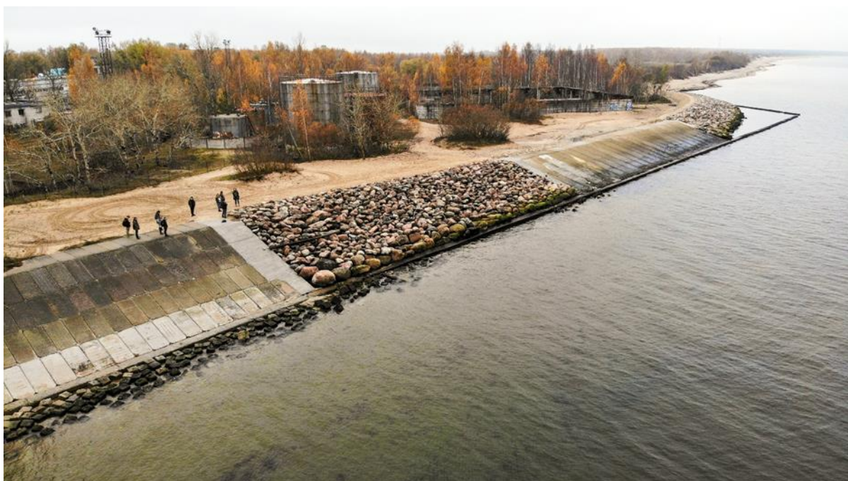
9. attēls. Tradicionālās pasīvā tipa preterozijas būves (atbangošanas slīpsiena un laukakmeņu bankete) Daugavgrīvas salas ziemeļaustrumos. Būves piekājē pilnībā erodēta pludmale un krasta iecirkni jāvērtē kā pilnībā mākslīgotu.
